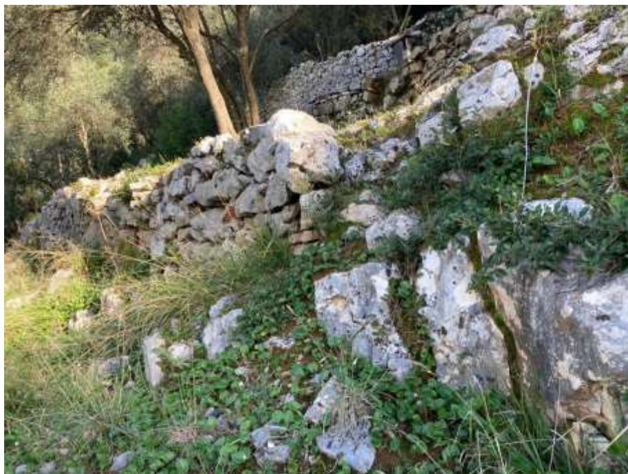
Figura 10 il cedimento dei muri a secco
